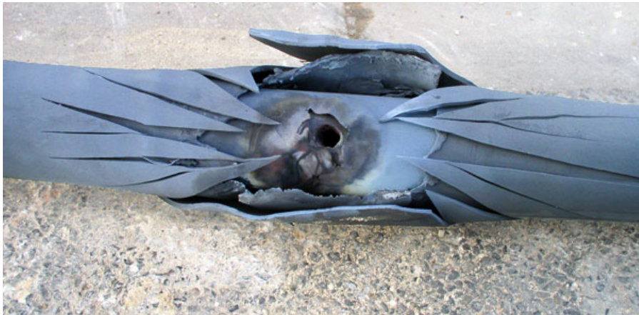
Figure 1 : Expansion explosive au niveau d'un câble (Source : Forma TIS, 2014)
