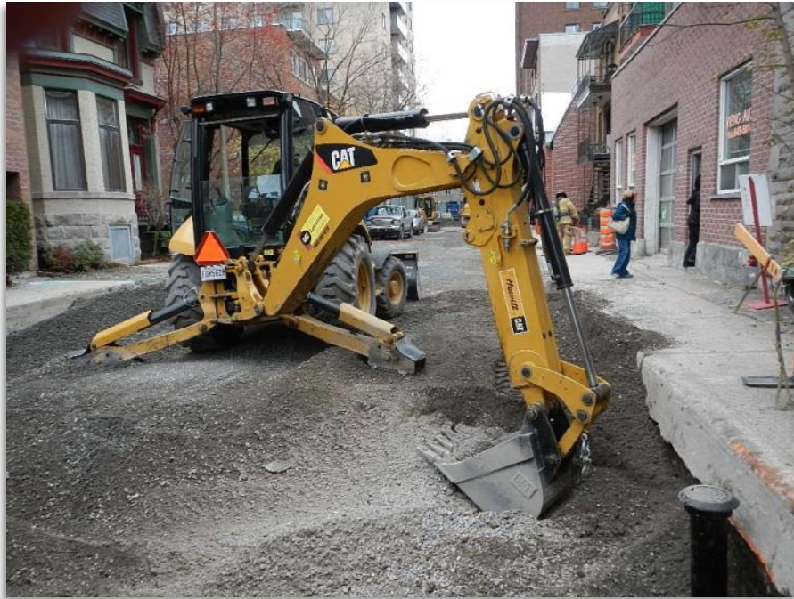
Figure 6 : Pelle mécanique responsable du bris
