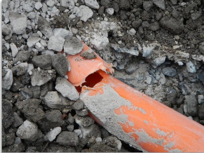
Figure 7 : Conduite de gaz touchée
