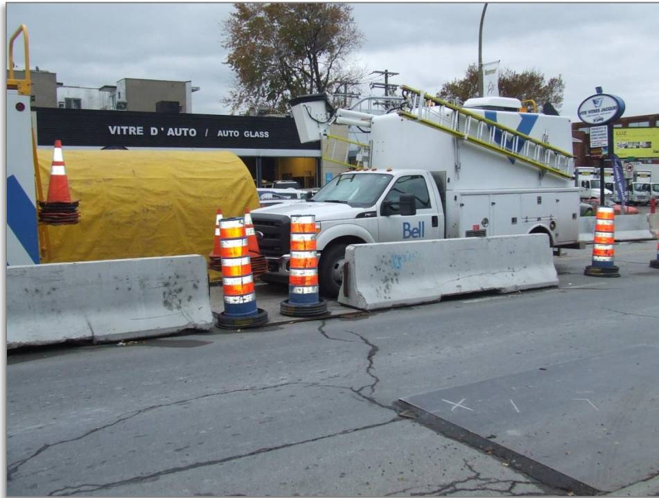
Figure 16 : Exemple de signalisation utilisée pour sécuriser les lieux d'un bris
